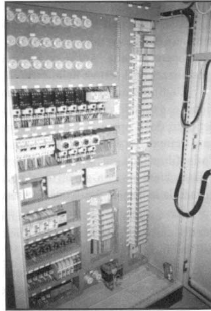
Fig. 2: Pannello elettrico di controllo del sistema
