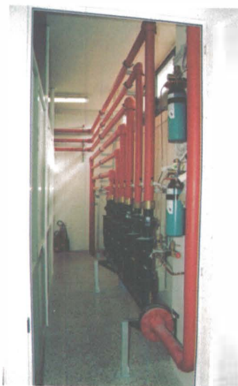
Impianto di sicurezza
